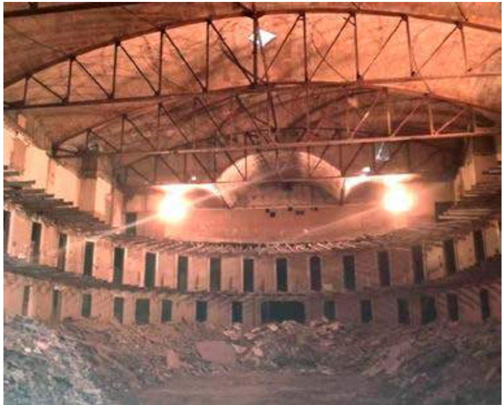
6. Demolition of L'Artesà in El Prat de Llobregat © Aturem l'enderroc, Salvem L'Artesà.
